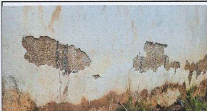
FOTO 12: CERNIDO EN PAREDES EN MAL ESTADO
