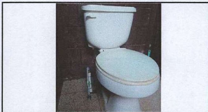
FOTO 6: ACCESORIOS EN MAL ESTADO EN LOS 4 SANITARIOS
