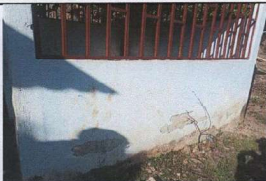
FOTO 11: CERNIDO DE PAREDES EN MAL ESTADO
