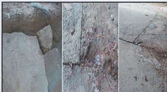
FOTO 4: SUSTITUIR LOSA DE PATIO
